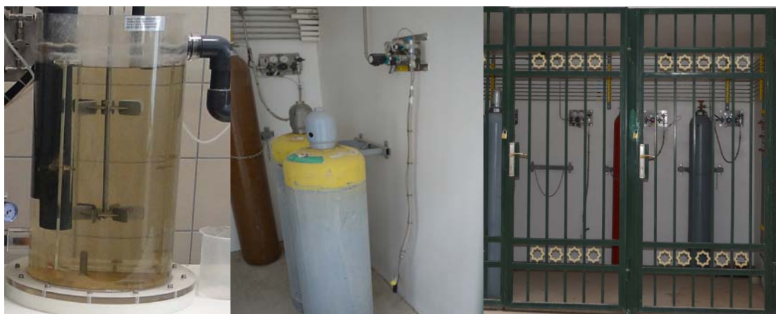
Рисунок №12. Обеспечение работы установки биохимической очистки сточных вод.
